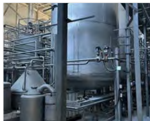
Основное производственное оборудование
