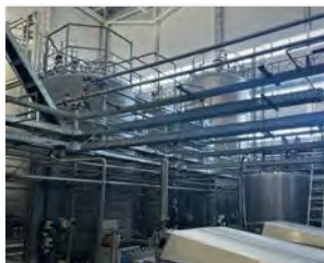
Основное производственное оборудование
